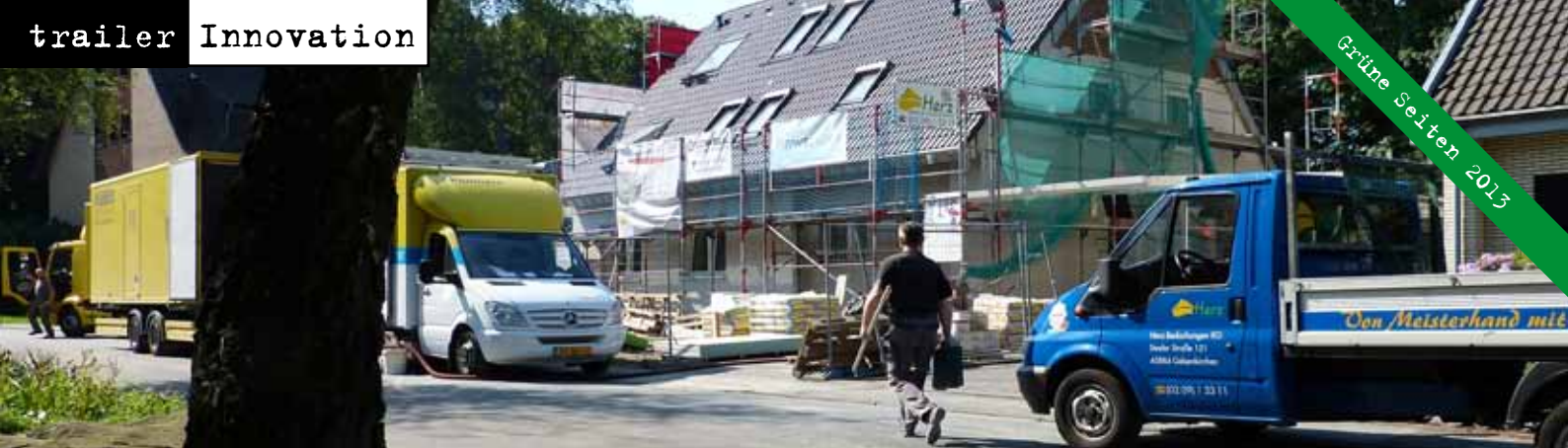
Vom energetischen Mittelmaß zum Plus-Energiehaus: Im Stadtteil Vonderort krepelt die „Innovation City“ gerade ein Einfamilienhaus komplett um, Foto: Tom Jost
